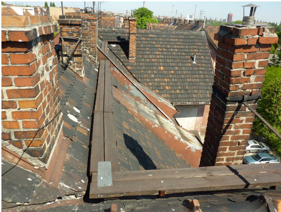
Fot. 3 Istniejące pokrycia dachu – podwójna dachówka karpiówka w kolorze czerwonym naturalnym.
