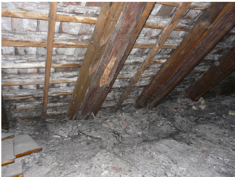
Fot. 5 Fragment więźby zaatakowany przez spuszczela
