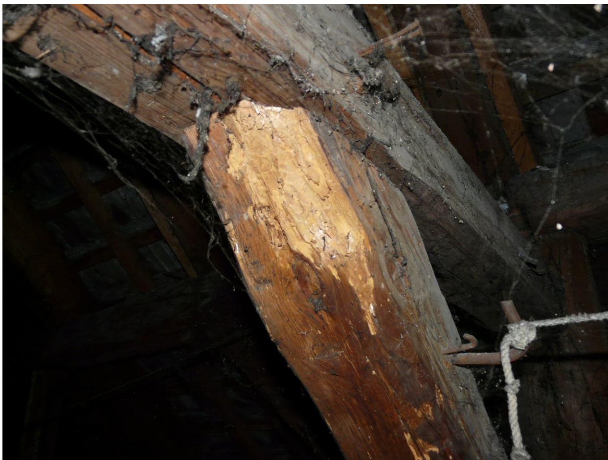
Fot. 4 Fragment więźby zaatakowany przez spuszczela
