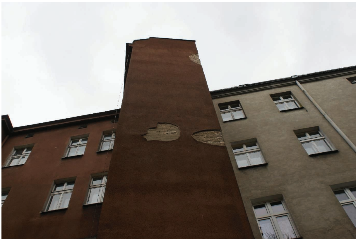
Fot.10. Elewacja od strony podwórza – zbliżenie. Widoczne uszkodzenia tynku.
