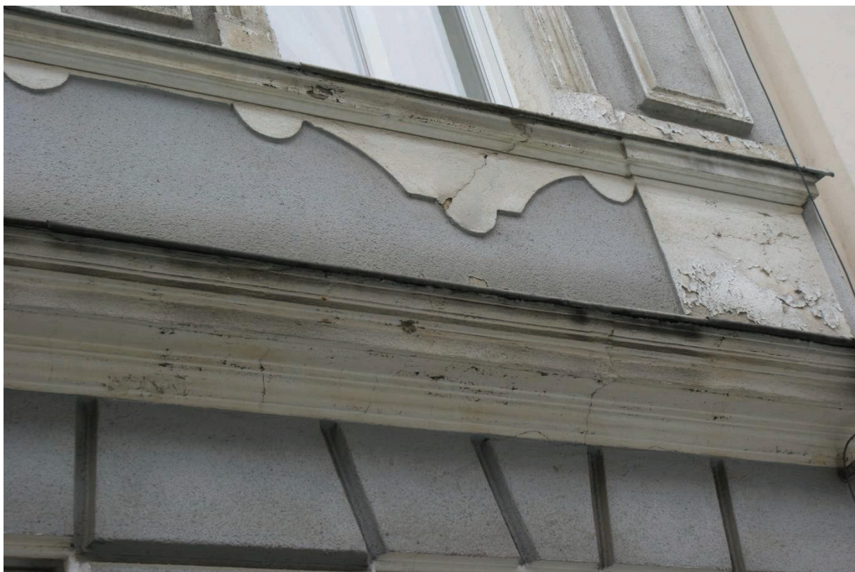
Fot.3. Elewacja frontowa – zbliżenie. Widoczne spękania gzymsu i złuszczenia powłok malarskich.
